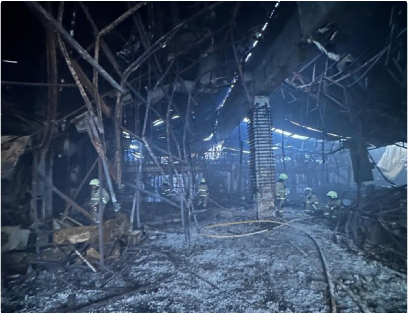
Glodok Plaza yang Hangus Terbakar
